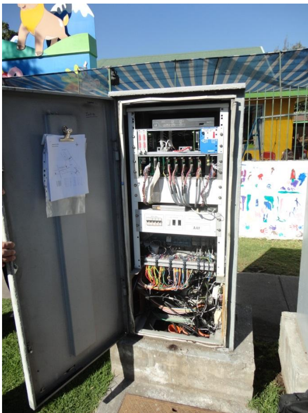
Foto 3 – Gabinete do controlador AUTER com porta aberta – Av. Patagônia x R. Los Domingos
