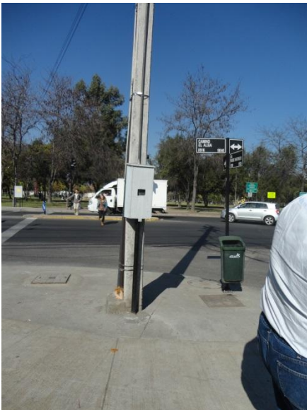
Foto 15 – Medidor de consumo de energia elétrica de controladores semafóricos
