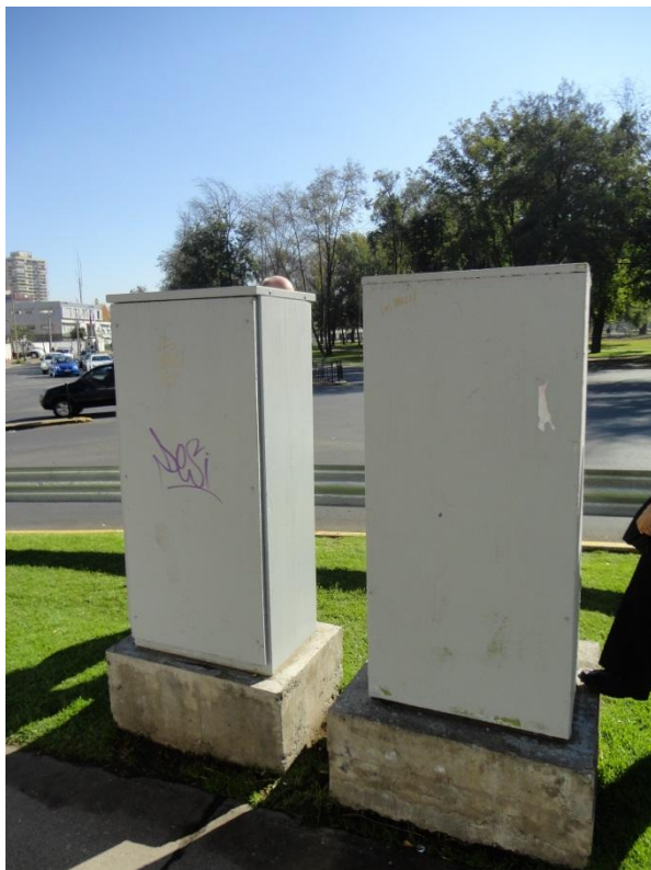
Foto 1 – Vista traseira do Nobreak (gabinete esquerdo) e Controlador Semafórico AUTER (gabinete direito) – Local: Av. Patagônia x R. Los Domingos
