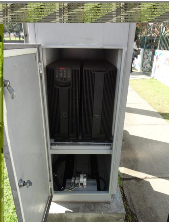
A Foto 2 mostra o gabinete do nobreak aberto. O equipamento da esquerda é o nobreak e o da direita é o conjunto de baterias. Potência do nobreak: 500watts; Autonomia: 3 horas
